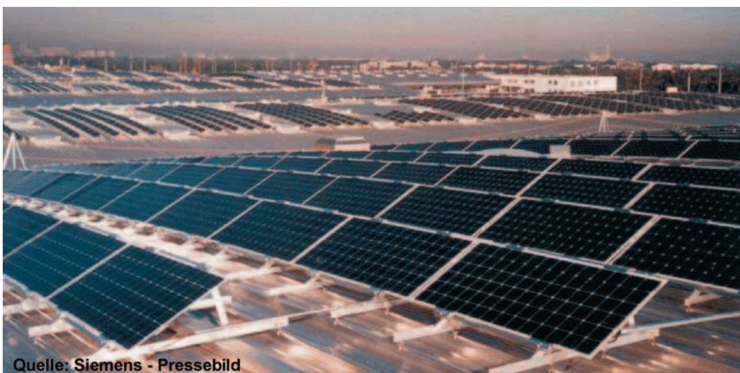
Abbildung 5 Gebäudeintegrierte 1-Megawatt-Photo- voltaikanlage, Fortbil- dungsakademie „Mont- Cenis“ in Herne.
