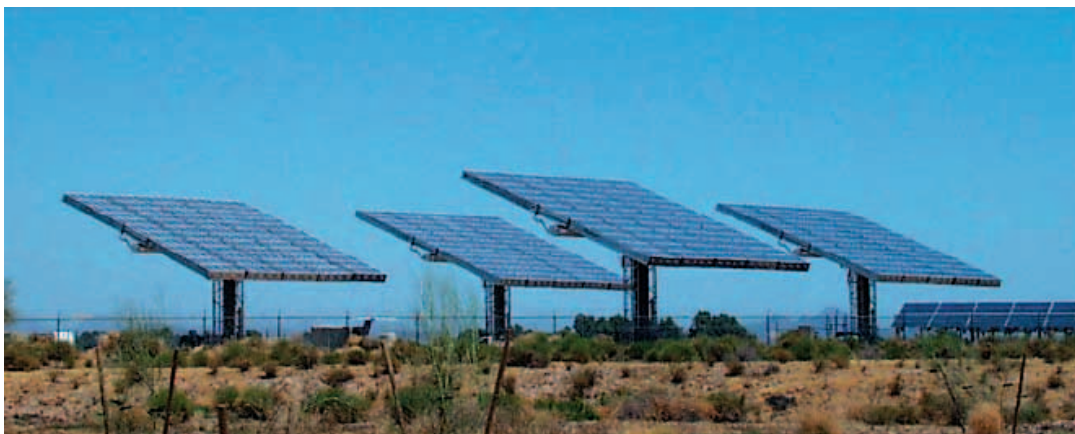
Abbildung 2 Vier 25 kW Amonix-Anlagen in Phoenix, Arizona, USA
